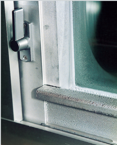
結露状況写真 室内温度：20℃ 外気温度：-10℃ 室内湿度：50%
